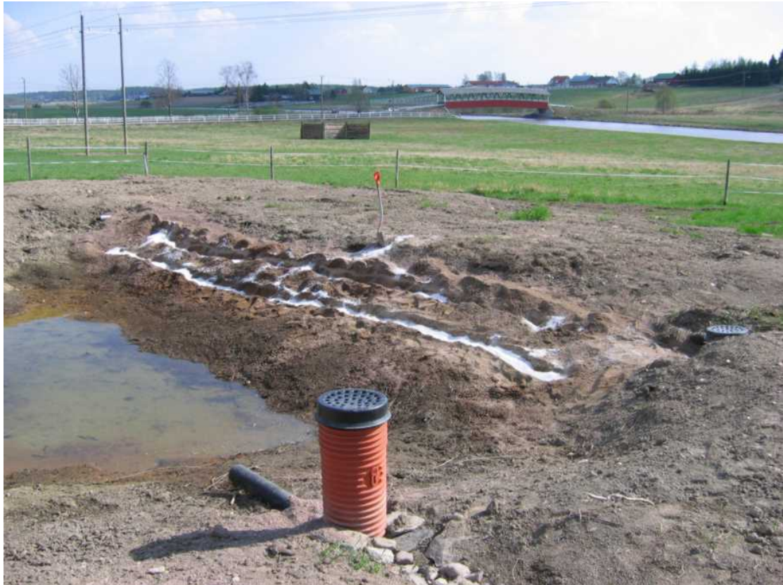
Kuva 7. Ypäjän koepuhdistamo. Kuvassa etualalla kemikaalin annostelukaivo. Altaan reunalla olevan hiekkasuodattimen sisään lisättiin rakeista kalkkia. Oikeassa reunassa altaan ylivuoto- ja hiekkasuodattimen salojan poistokaivo.
